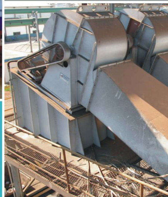
INSTALADO NA EQUIPAV S/A - PROMISSÃO-SP SISTEMA CTC
